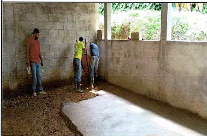
Foto 3: Piso de Aula
